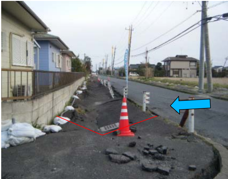
側方流動により折れた歩道
