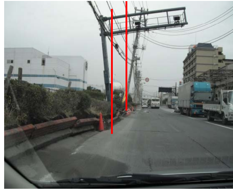
浦安市県道被害状況
