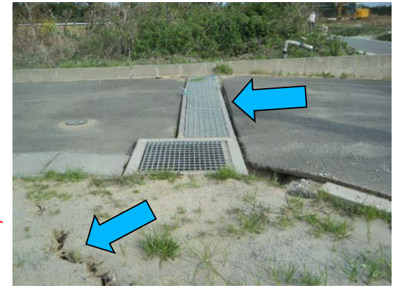
側方流動により開いた舗装
