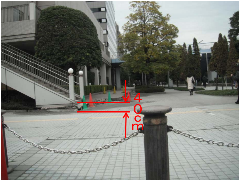
公共施設の杭の抜け上がり
