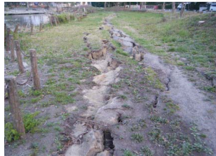
公園の池の地割れ
