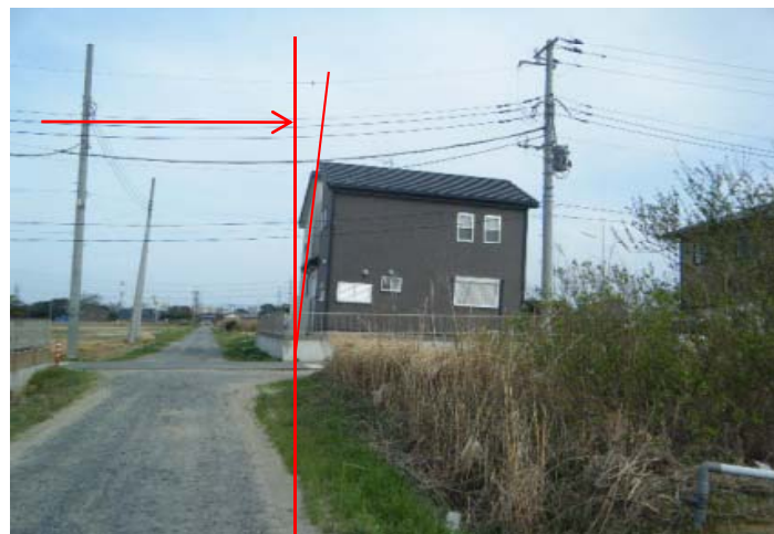
道路から奥方向に不同沈下した家
