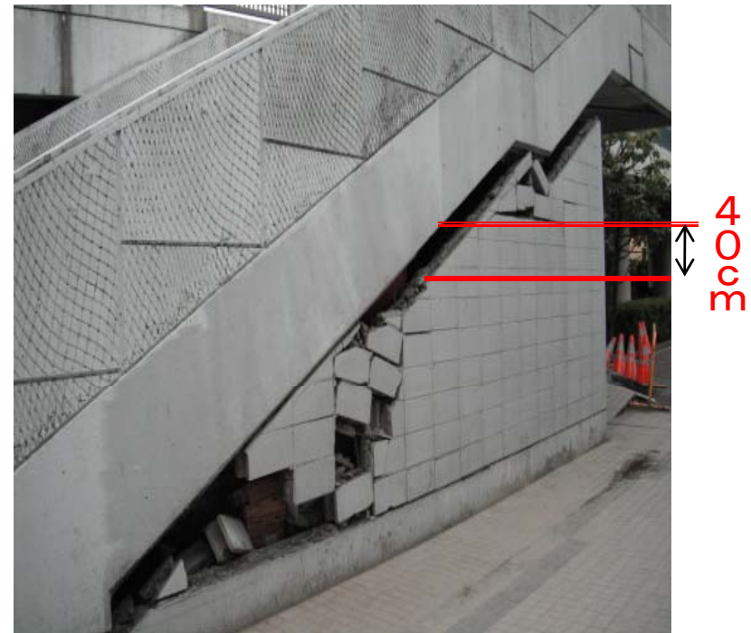
舞浜駅正面の歩道橋下地盤沈下
