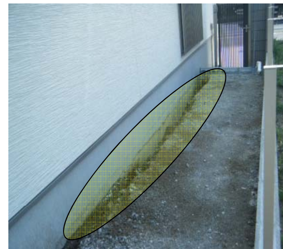
基礎の脇から水が湧いた跡
