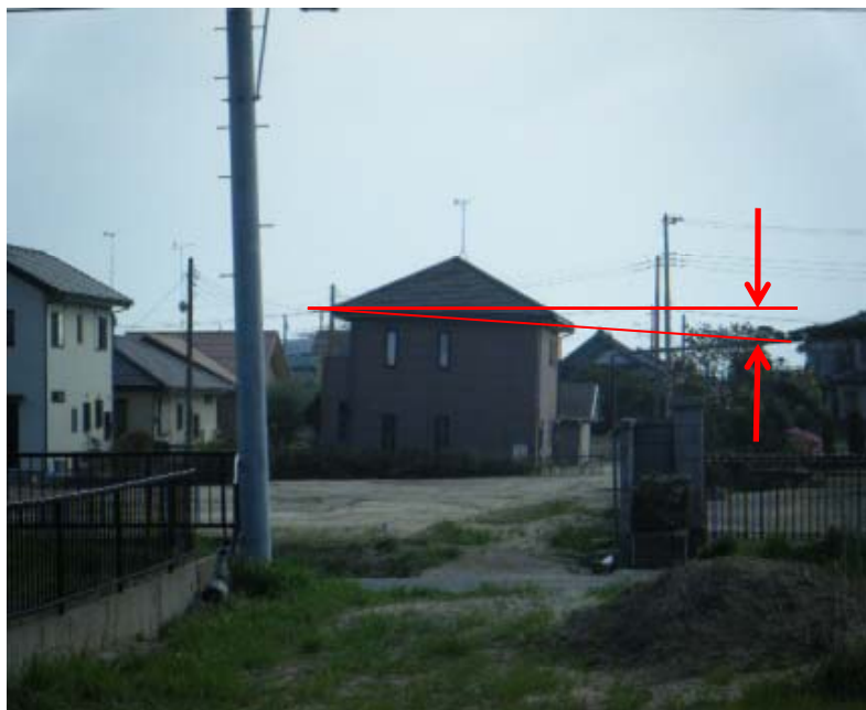
不同沈下した家
