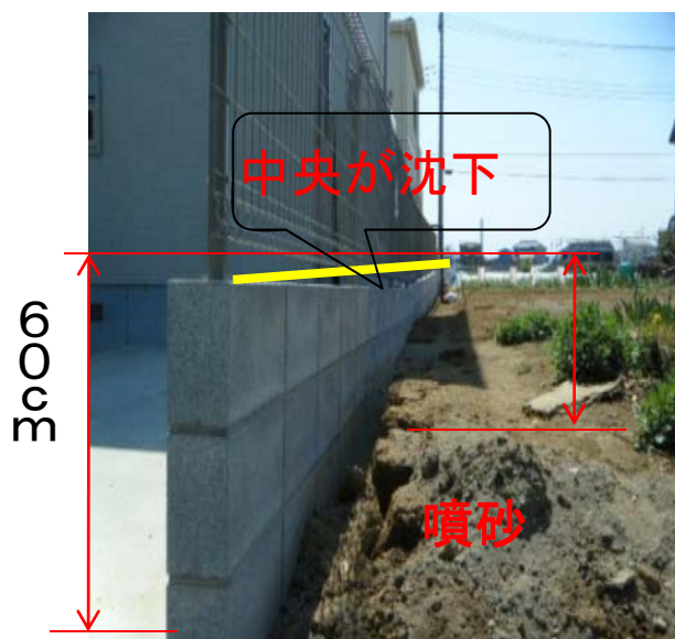
噴砂と沈下した家の状況
