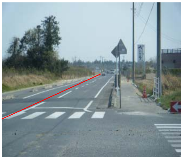
液状化により波打つ路面
