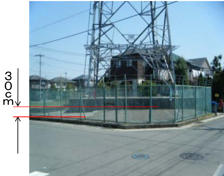
鉄塔基礎の抜け上がり
