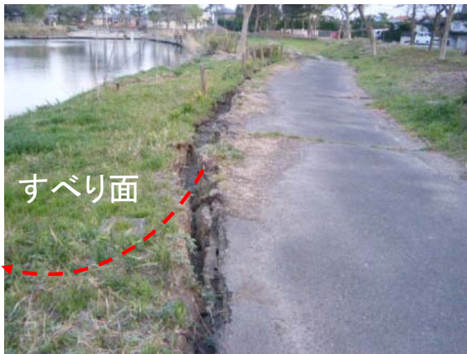
公園の池の地割れ
